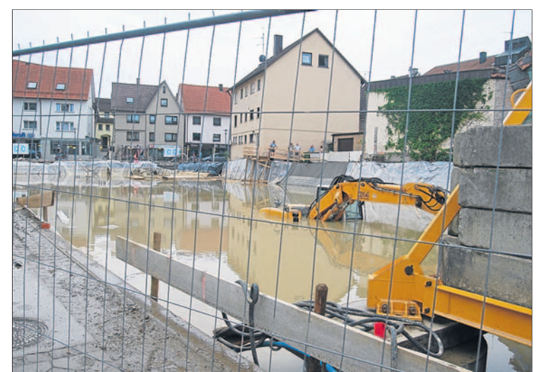
Der Bagger in einer Ditzinger Baugrube verschwindet in einem See.
